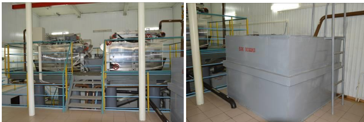
Рисунок 2.113 - Ленточный фильтровальный пресс (слева), накопительный бак осадка (справа) КОС-15000
