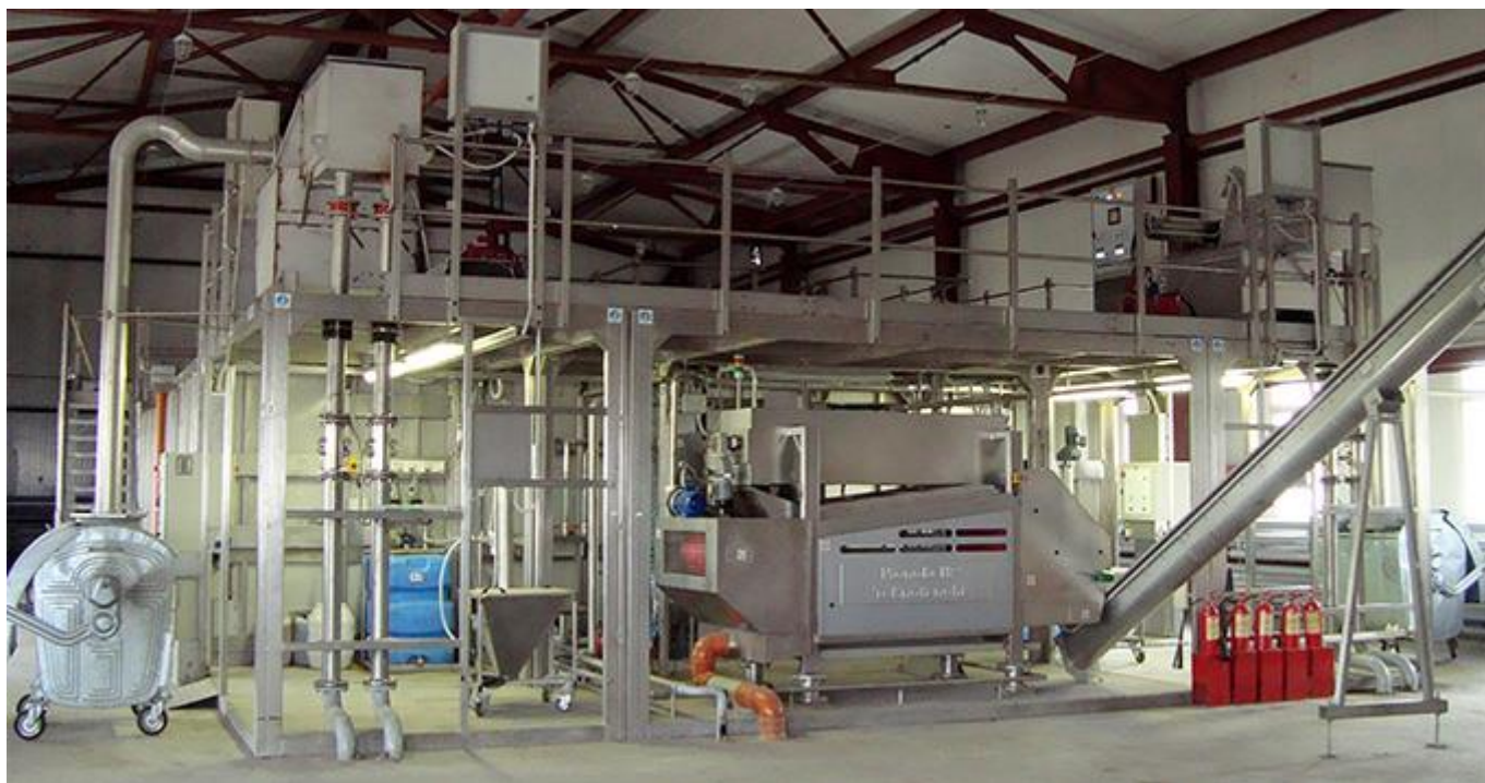
Рисунок 5.1 – Канализационные очистные сооружения в блочно-модульном исполнении
