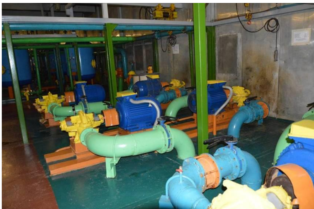
Рисунок 2.8 – Насосное оборудование II-ого подъема ВОС-15000 ГО Радужный
