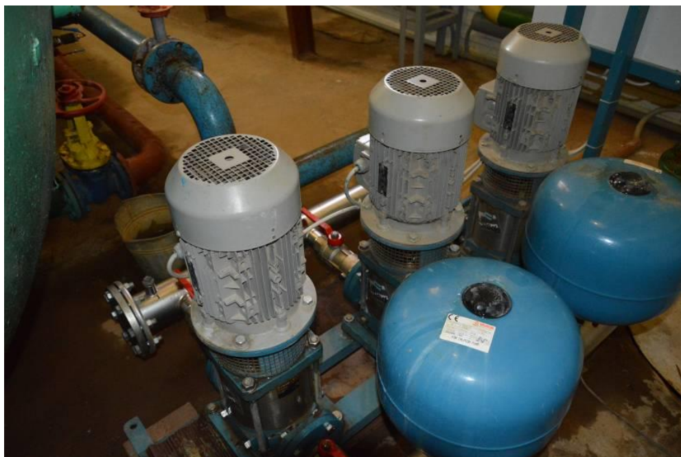
Рисунок 2.9 - Насосное оборудование II-го подъема ВОС-1000 ГО Радужный
